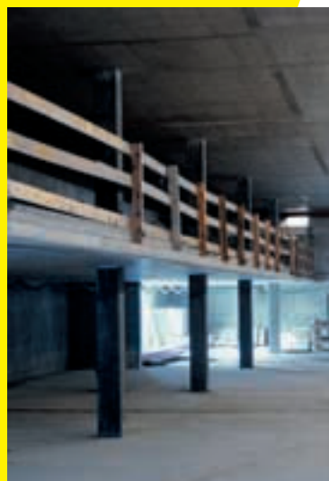
5 Des protections latérales contre les chutes.
