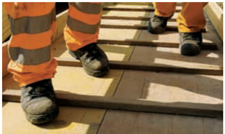
4 Des protections antiglisse sur les accès au chantier.
