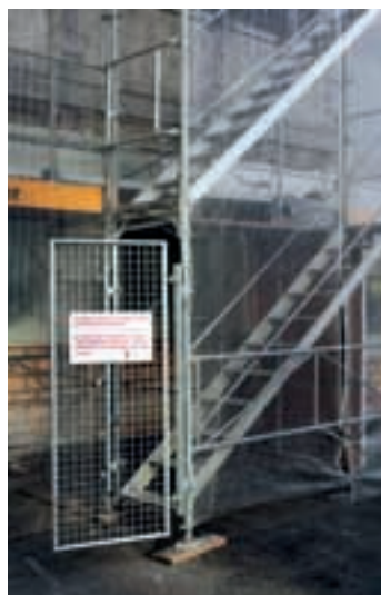
7 Des accès sûrs à l'échafaudage.
