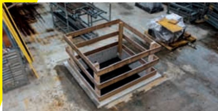
9 Une barrière autour des ouvertures de sol.
